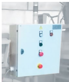
Стационарный пульт управления системами агрегата
